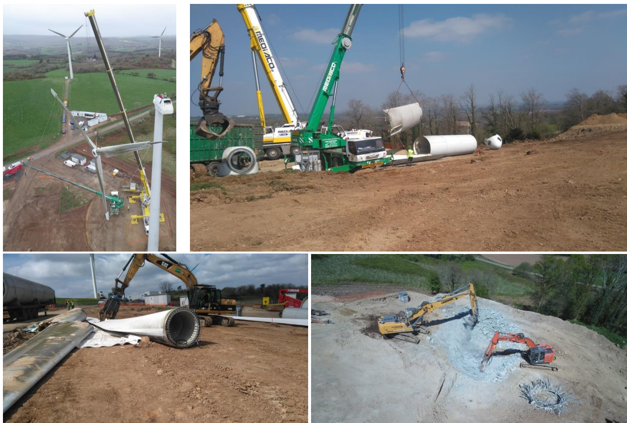
Figure 8 : démantèlement du parc éolien de Plouyé (démontage de l'éolienne, cisailage de la pale, destruction de la fondation)
