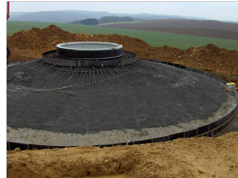
Figure 9 : Exemple de ferrillage en radier pour une éolienne (chantier en cours, source Vestas)
