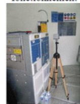
mesure n° 4 à l'entrée de l'éolienne près du transformateur
