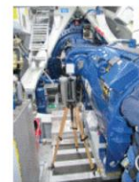
mesure n° 2 nacelle proche du générateur
